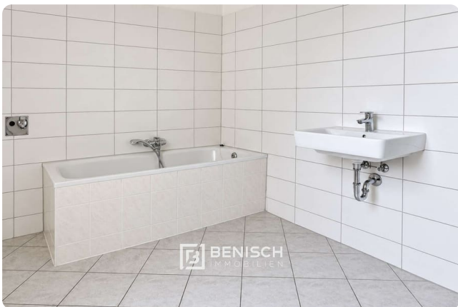
Bad mit Badewanne und Waschmaschinenanschluss
