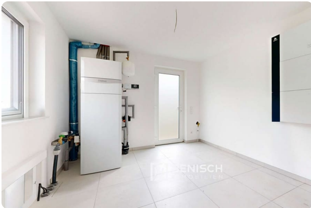
Hauswirtschaftsraum mit Batteriespeicher und Puffersepeicher
